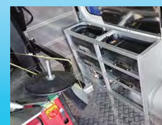
リチウムイオン電池搭載状態 (撮影の為開梱しています)
