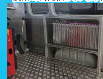
EVリユースリチウムイオン電池 (撮影の為開梱しています)
