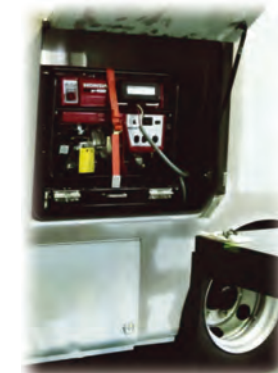
発電発電機搭載例
